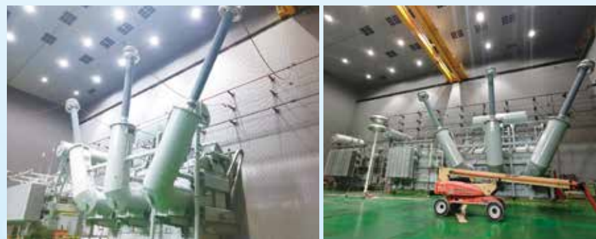
華城電機研製之 525kV 超高壓變壓器，具備抗 50°C 高溫與極低噪音特性，成功打入美國高階電力市場。
