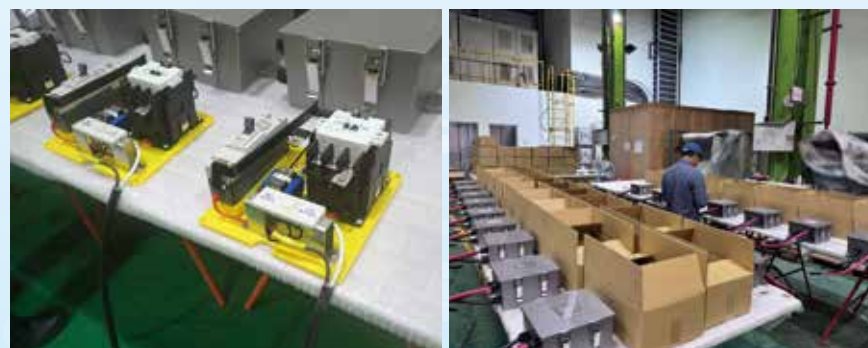
雙切開關由系統控制線（集中控制）與無熔線斷路器（NFB）負載側引接，當集控異常時可即時切換至內部控制，確保路燈不中斷運作
